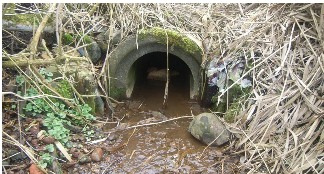
Figur 1.3 Indløb til rørledning AAL-1301.
